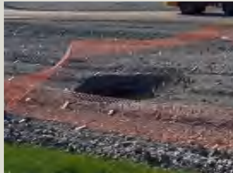
路堤底部发生坍塌
