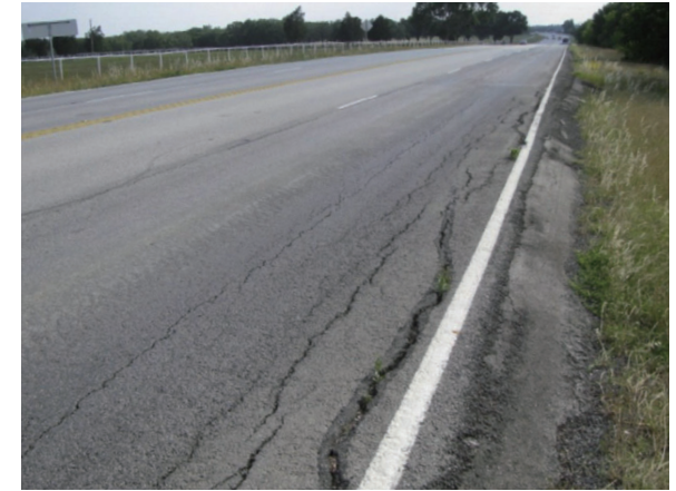
膨胀粘土路基路面纵向边缘裂缝
