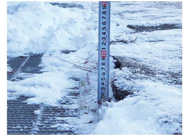
路基冻胀导致铺装路面开裂
