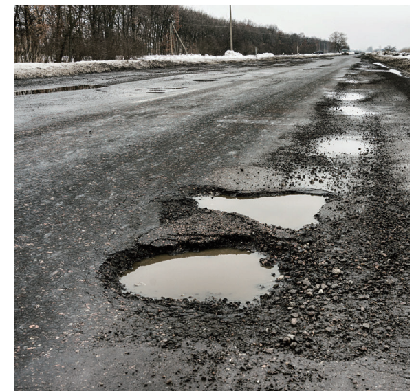
冻胀导致开裂的路面冰沸
