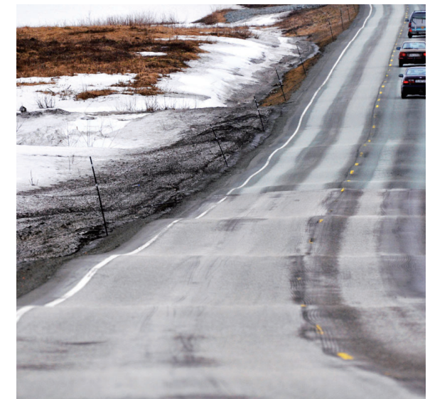
路基冻胀导致铺装路面隆起
